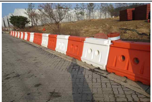
현장 인접도로 주변 안전시설(PE방호벽) 설치 현황
