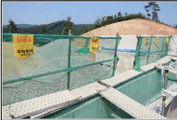
상부 안전난간 설치 현황
