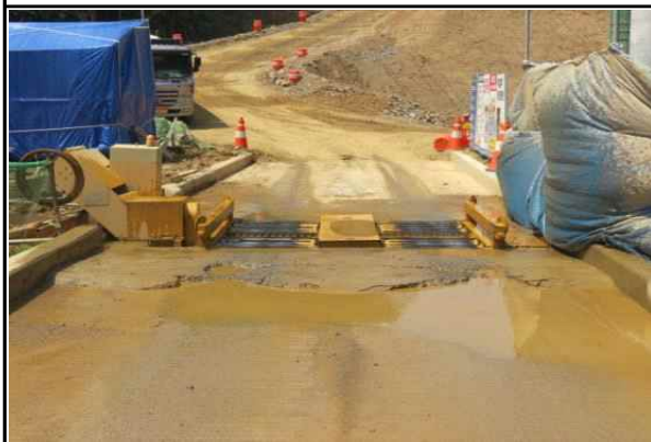
현장 진출입로 세륜기 설치 현황
