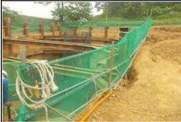
교각 P1 주변 안전시설 설치 현황
