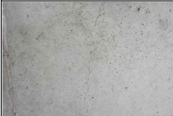
교대 A1 전면 벽체 균열(2016.06.13) (보수계획 수립 및 지속적인 관리 중)
