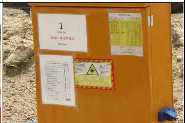
현장내 가설분전반 설치·운용 현황
