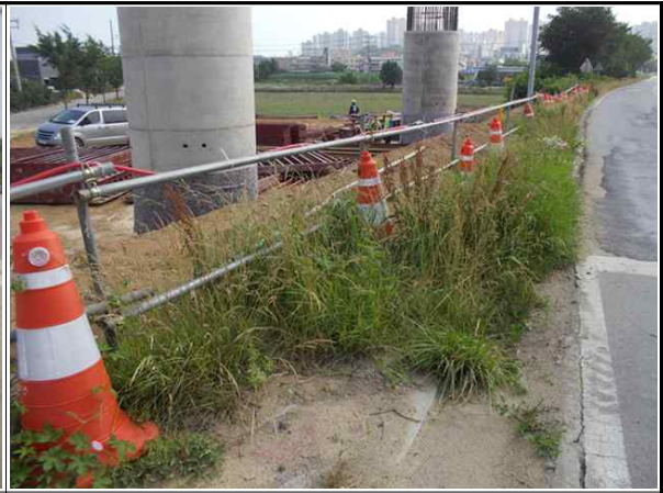
현장 인접도로 주변 안전시설 설치 현황
