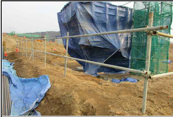
현장내 안전난간 설치 현황①
