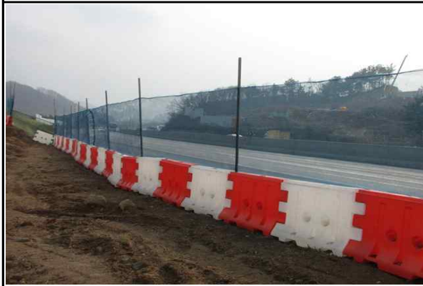
현장 인접도로 주변 안전시설(PE방호벽) 설치 현황
