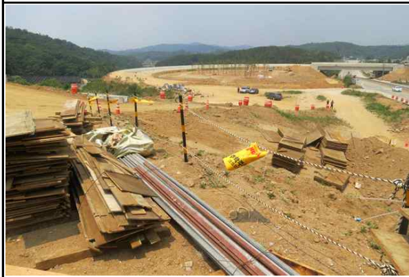
현장내 안전시설 설치 현황③
