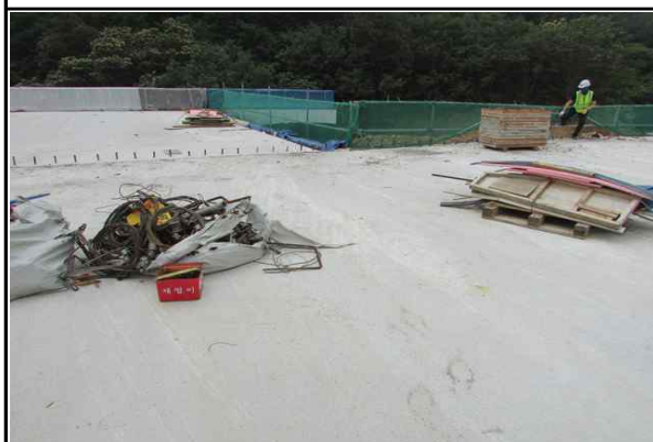
상부 교면 자재정리 미흡② (조치전)
