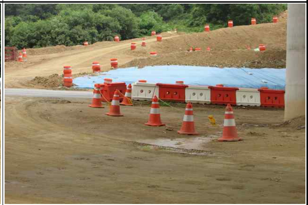
현장내 안전시설 설치 현황⑥
