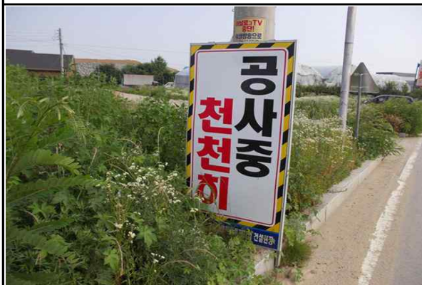
현장 인접도로 주변 공사안내 표지판 설치 현황
