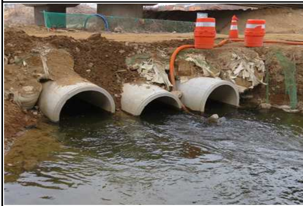
현장내 가설도로 및 임시배수관 설치 현황
