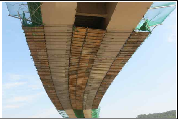
상부 낙하물 방지시설 설치상태 양호
