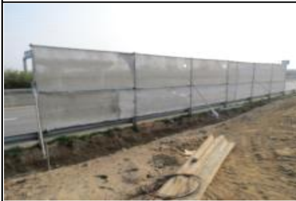
현장 내 인접도로 웬스 설치 현황
