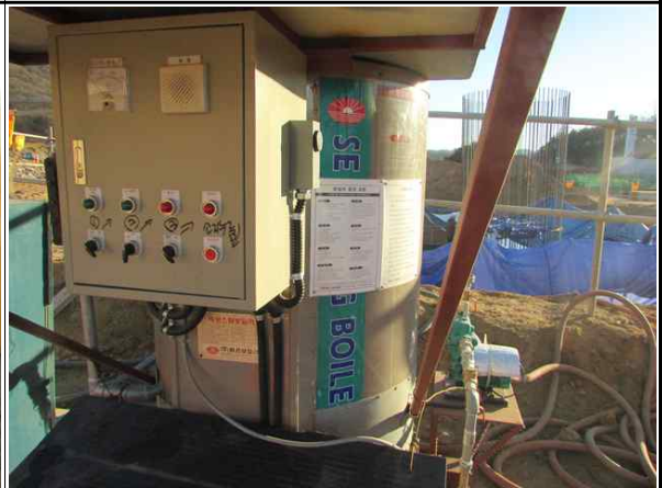
현장내 가설 보일러 설치·운용 현황②
