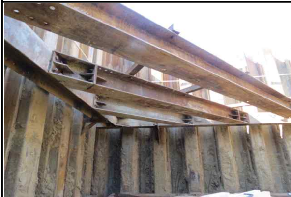
가시설 떠장, 사보강재 설치 상태 양호
