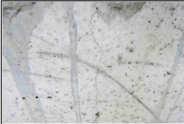
교대 A1(오창방향) 전면벽체 균열(2016.03.08.) (보수계획 수립 및 지속적인 관리 중)
