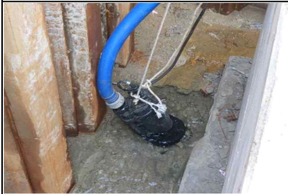
교각 P2 양수기 설치·운용 현황 (2015.04.07)
