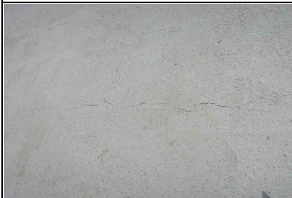
상부슬래브 균열(폭 0.3mm미만)(16.06.13) (보수계획 수립 및 지속적인 균열관리 중)
