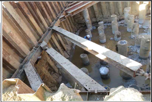
교각 P1(오창방향) 가시설 띠장 사보강재 접합부 상태
