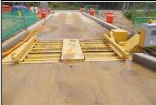
현장 진출입로 세륜기 설치 현황
