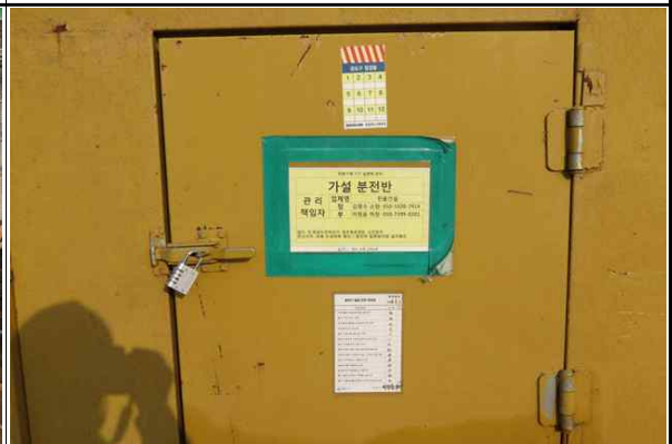
가설 분전반 잠금 및 관리 상태 양호
