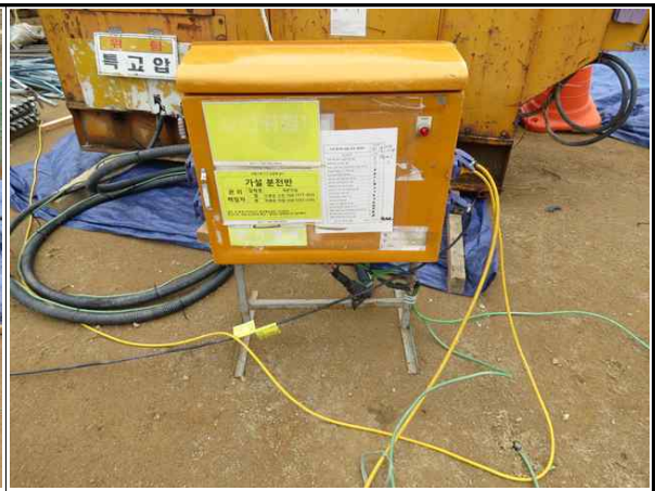
현장내 가설 분전반 설치 및 운용 상태 양호
