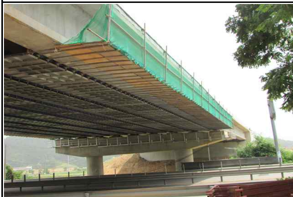
상부 추락방지시설 설치 현황
