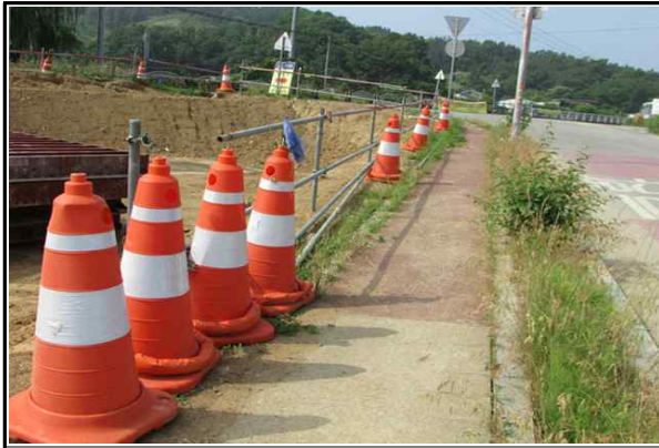
현장 인접도로 주변 안전시설 설치 현황
