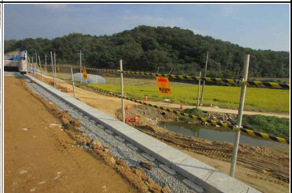
추락방지를 위한 안전시설 설치 현황②
