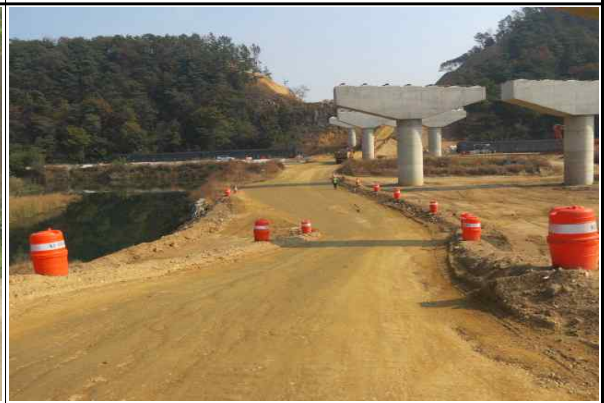
현장내 안전시설(PE드럼) 설치 현황
