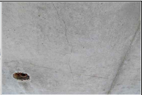
교대 A1 전면벽체 균열(15.12.18) (보수계획 수립 및 지속적인 관리 중)
