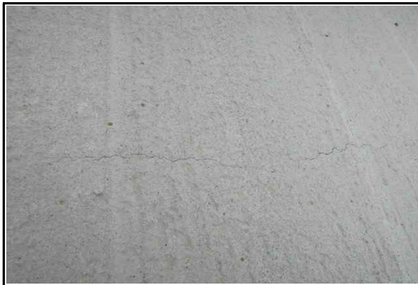
상부슬래브 균열(폭 0.3mm미만)(2016.06.13) (보수계획 수립 및 지속적인 균열관리 중)
