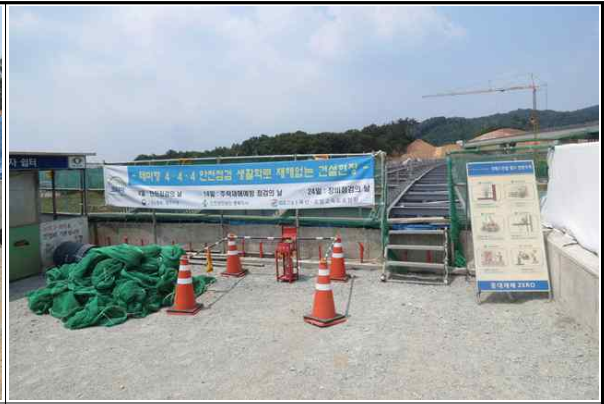
종점측 진입부 안전시설 설치 현황
