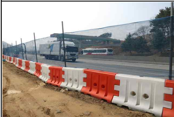
현장 인접도로 주변 안전시설(PE방호벽) 설치 현황①
