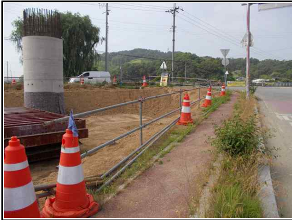
현장 인접도로 주변 안전시설 설치 현황
