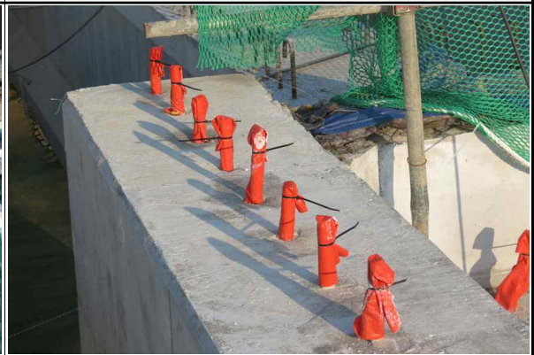
노출철근 보호덮개 설치상태 양호② (2015.12.11)
