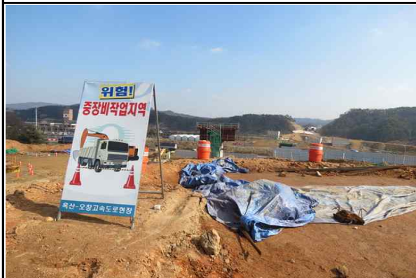
작업장 주변 안전시설(안전간판 등) 설치 현황
