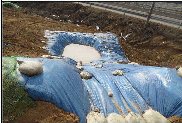
침사지 설치·운용 현황
