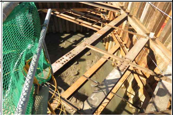
가시설 떠장, 사보강재 설치 상태 양호
