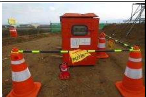
가설배전반 운용 상태 양호
