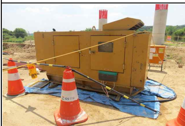
현장내 가설발전기 설치·운용 현황
