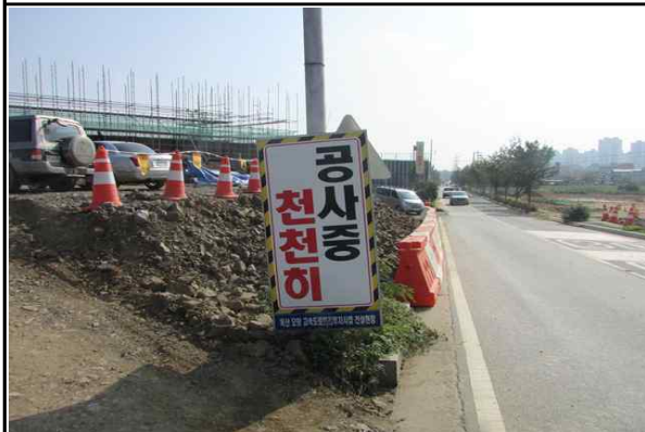
현장 인접도로 주변 공사안내 표지판 설치 현황
