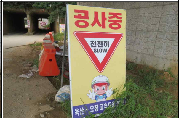
시점측 인접도로 주변 안전시설(안전간판) 설치 현황
