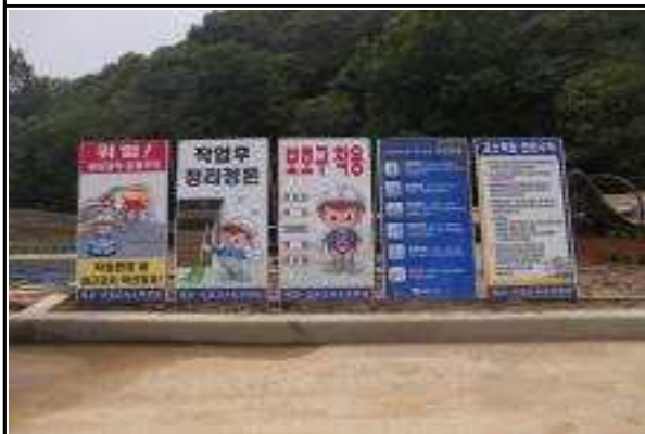
현장내 안전간판 설치상태 양호
