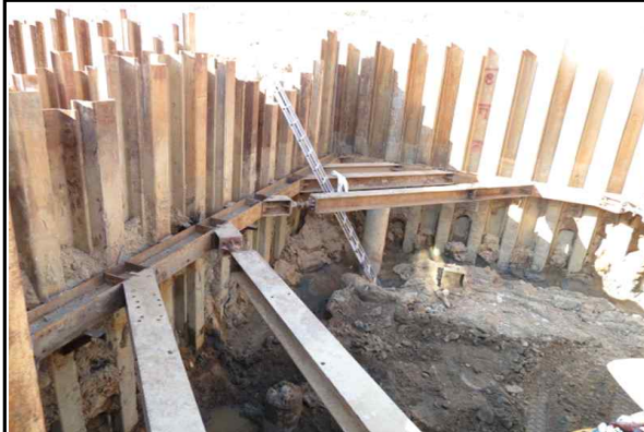
교각 P1(옥산방향) 가시설 띠장 사보강재 접합부 상태
