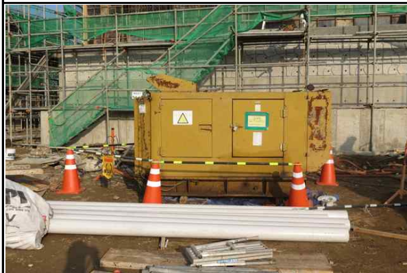
현장내 가설 분전반 설치 및 운용 현황
