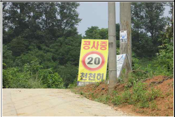
현장내 안전간판 설치상태 양호
