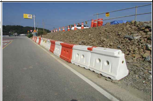
현장 인접도로 주변 안전시설 설치 현황
