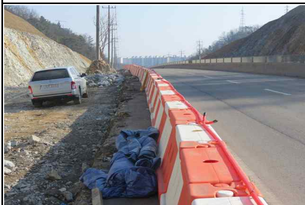
인접도로 주변 안전시설(PE방호벽) 설치 현황①
