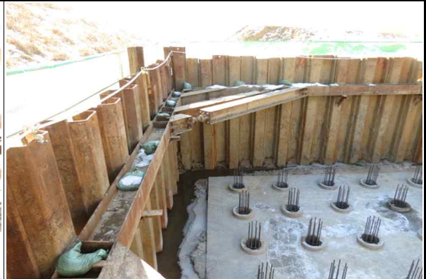
교각 P2(오창방향) 가시설 띠장 사보강재 접합부 상태
