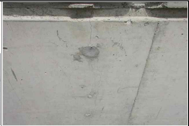
교대 A2 전면벽체 균열(2016.06.13) (보수계획수립 및 지속적인 관리 중)
