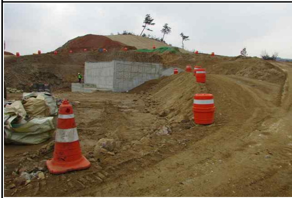
현장내 안전시설 설치 현황③
