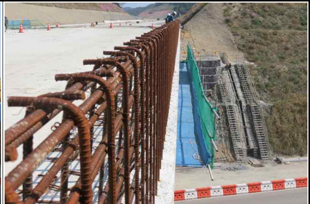
상부 낙하물 방지지설 설치 현황②
