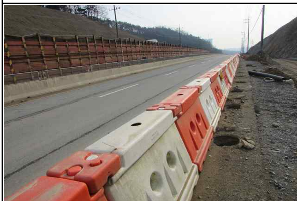
인접도로 주변 안전시설(PE방호벽) 설치 현황
