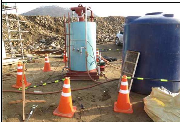
현장내 가설 보일러 설치 및 운용 현황①
