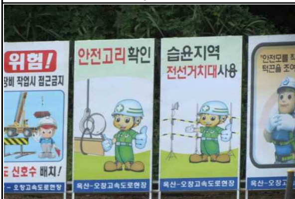
현장내 안전간판 설치상태 양호
