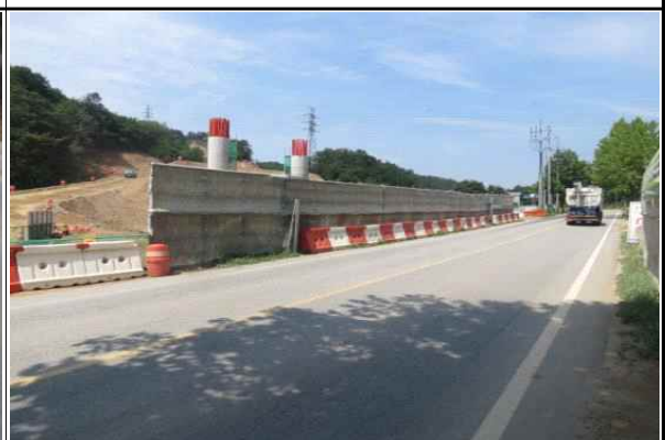
현장 인접도로 안전시설 설치 현황 ②
