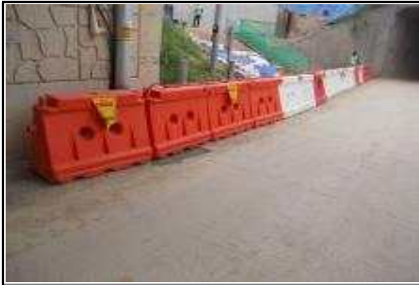
횡단 도로내의 안전시설 설치 현황
