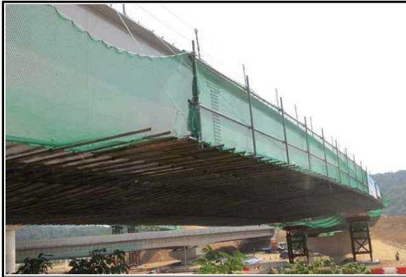
상부 낙하물방지시설 설치 상태양호
