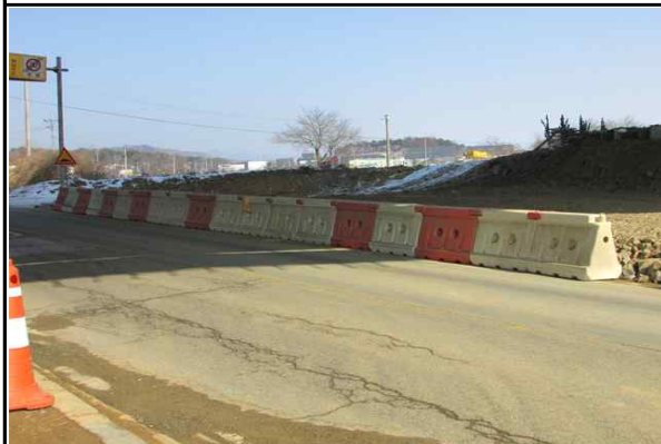
현장 인접도로 주변 안전시설 설치 현황
