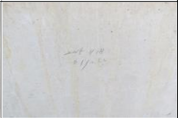
교각 P1 기둥부 균열(폭 0.3mm미만) (보수계획 수립 및 지속적인 균열관리 중) (2015.12)
