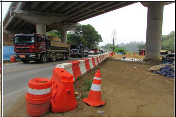
인접도로 안전시설(PE방호벽 등) 설치 현황
