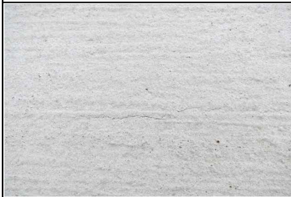
상부 슬래브 균열(폭0.3mm미만)(2016.03.08) (보수계획 수립 및 지속적인 균열관리 중)
