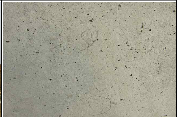
교대 A2 구체부 균열(폭 0.3mm미만) (균열관리대장 작성 관리중)(2017.01.12)
