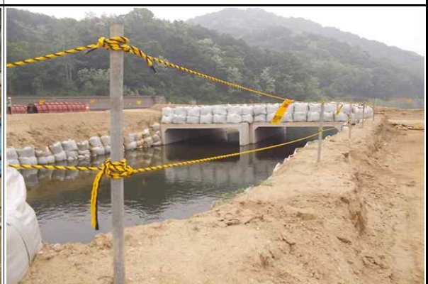
인접하천 주변 안전네트 설치 현황
