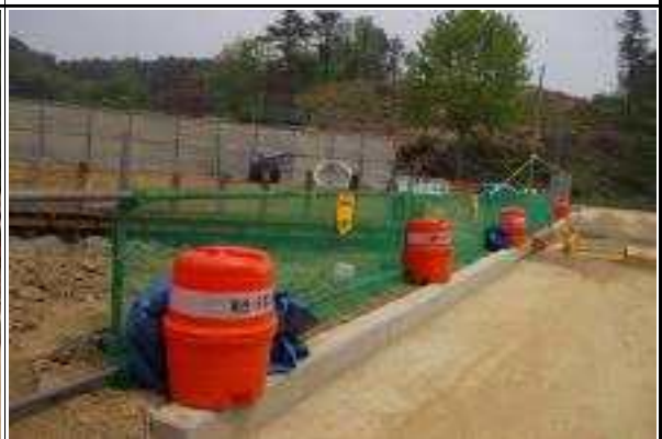
현장 진출입로 안전시설 설치상태 양호
