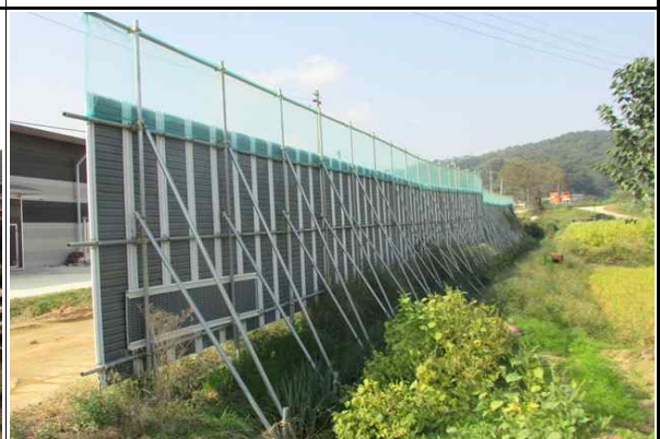
인접 농가시설 주변 안전휀스 설치 현황④
