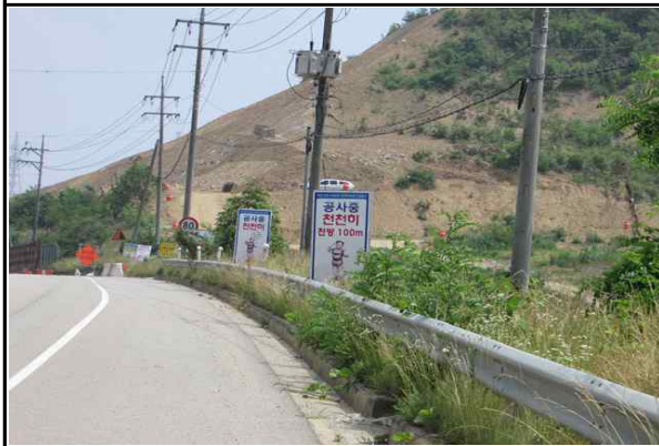
인접도로 공사안내간판 설치상태 양호
