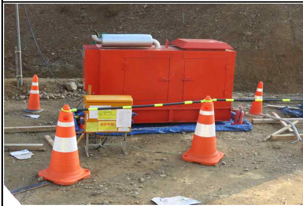
현장내 가설 분전반 설치 및 운용 현황
