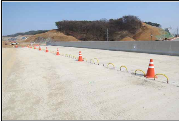
현장내 안전시설 설치 현황③
