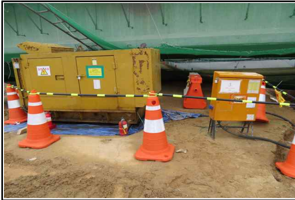
가설 분전반 설치·운용 현황
