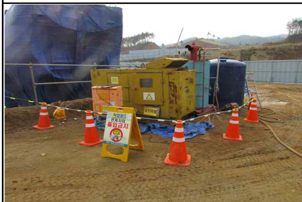
현장내 가설 발전기 설치 및 운용 현황
