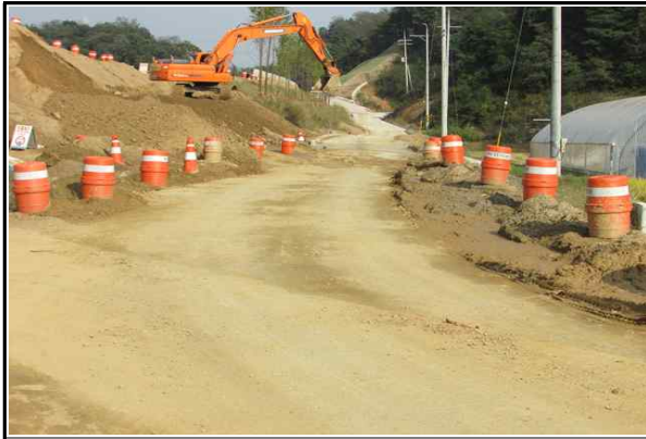
안전시설(PE드럼, 라바콘) 설치 현황①
