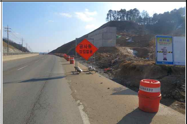
인접도로 주변 안전시설(PE드럼) 설치 현황
