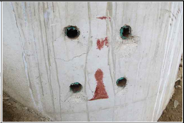
교각 P2 기둥부 박리 및 파손 발생 (보수계획 수립)(2017.04.07)
