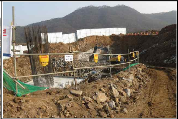
현장내 안전난간 설치 현황
