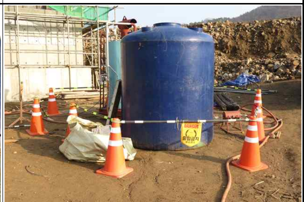
현장내 가설 보일러 설치 및 운용 현황②
