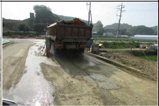
현장 진출로 세륜기 설치·운용상태 양호
