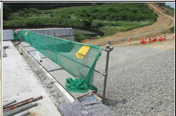
작업장내 안전난간 설치 현황
