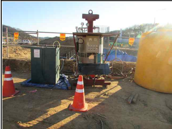
현장내 가설 보일러 설치·운용 현황①
