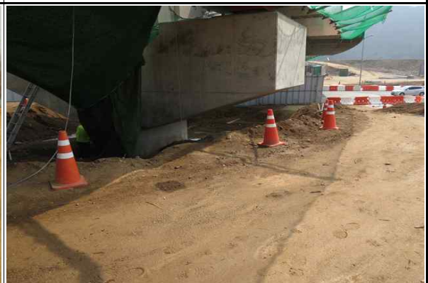
교각 P2 기초 작업장 주변 추락방지를 위한 안전웬스 및 라바콘 설치 현황
