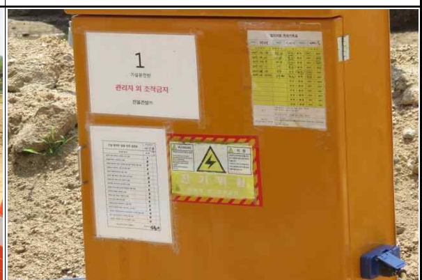
현장내 가설분전반 설치·운용 현황
