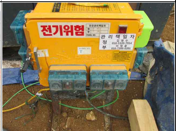
현장내 가배전반 설치·운용 현황②
