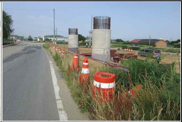
현장 인접도로 주변 안전시설 설치 현황
