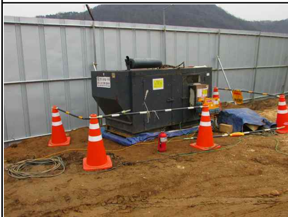
현장내 가배전반 설치·운용 현황①
