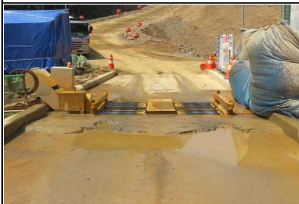
현장 진출입로 세륜기 설치 현황
