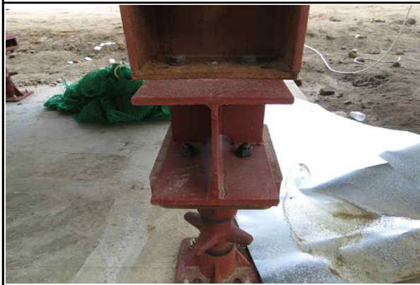
가설벤트 볼트 및 접합부 체결상태 양호①
