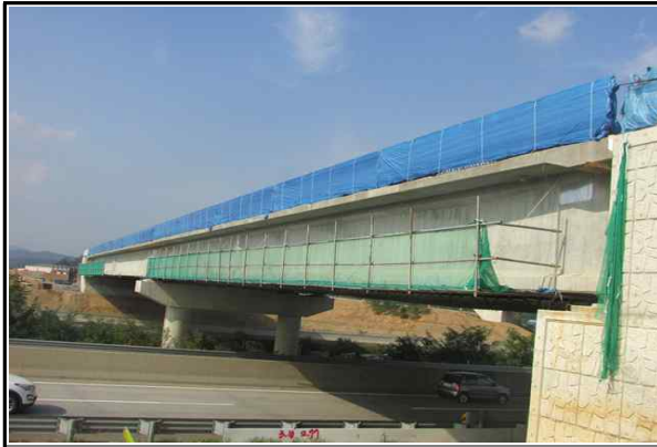
상부 추락방지시설 설치 현황
