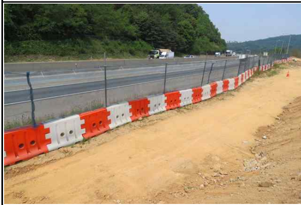
현장 인접도로 주변 안전시설 설치 현황①
