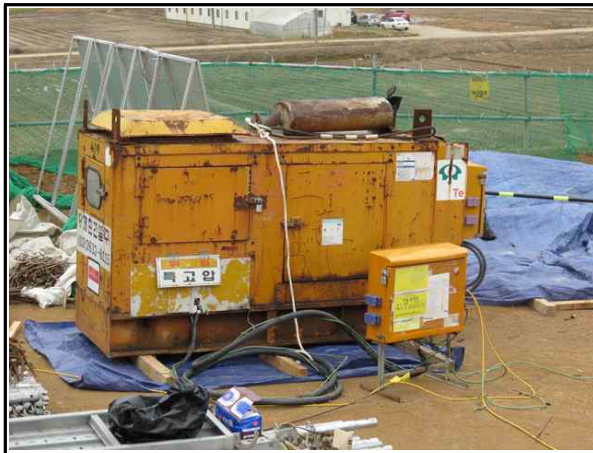
현장내 가설 발전기 설치 및 운용 현황
