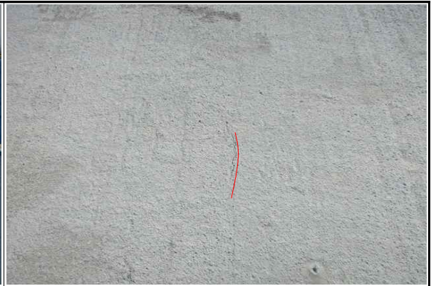
상부슬래브 균열(폭 0.3mm미만)(2016.10.11) (보수계획수립 및 지속적인 균열 관리중)
