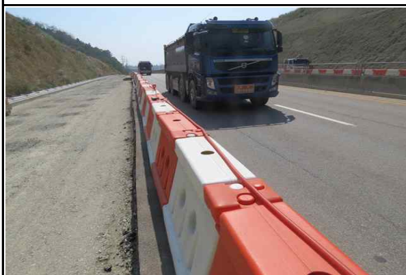
인접도로 주변 안전시설(PE방호벽) 설치 현황①
