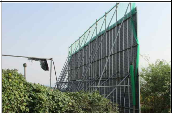
안전휀스 설치 및 고정 상태 양호
