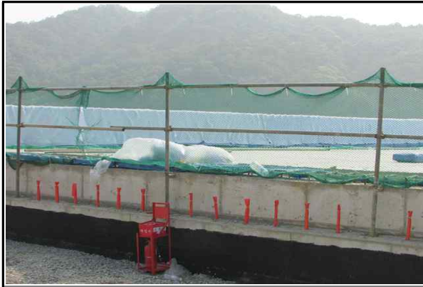
안전난간 설치상태 양호
