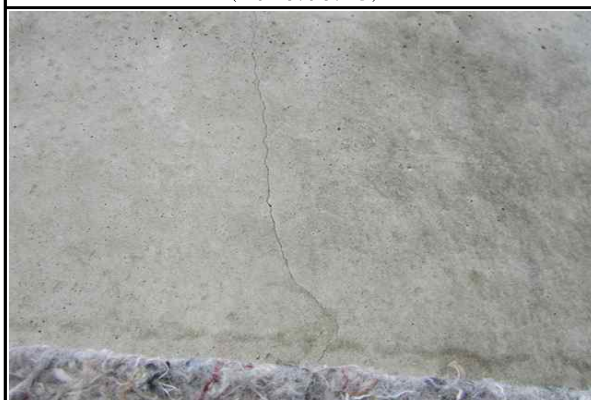
교각 P1 기둥부 균열 (2016.06.13) (보수계획 수립 및 지속적인 관리 중)
