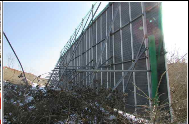
안전휀스 설치 및 고정 상태 양호
