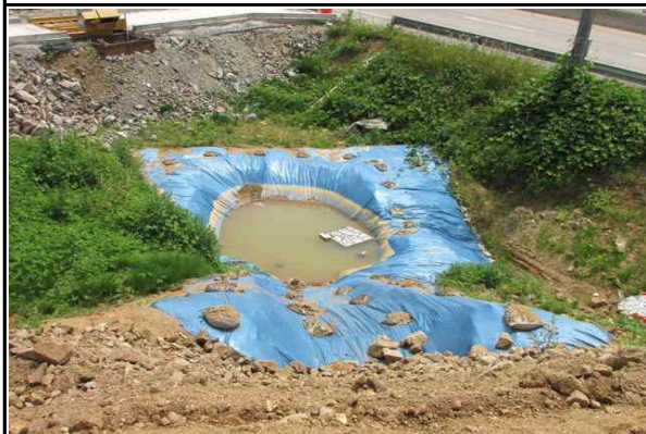
침사지 설치·운용 현황
