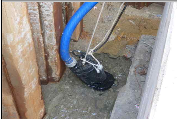
교각 P2 양수기 설치·운용 현황 (2015.04.07)
