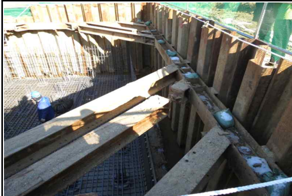
교각 P2(옥산방향) 가시설 띠장 사보강재 접합부 상태
