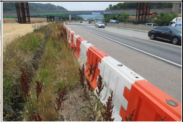
현장 인접도로 주변 안전시설 설치 현황②
