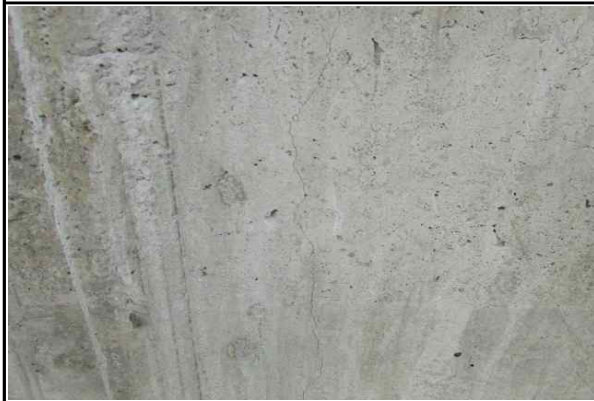
교대 A1 배면 벽체 건조수축 균열(2016.12.13) (보수계획 수립 및 지속적인 관리중)
