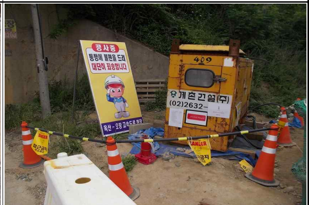
가배전반 설치 및 운용 상태 양호
