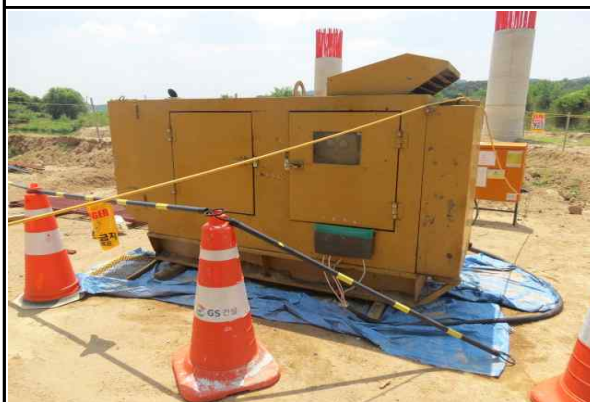
현장내 가설발전기 설치·운용 현황
