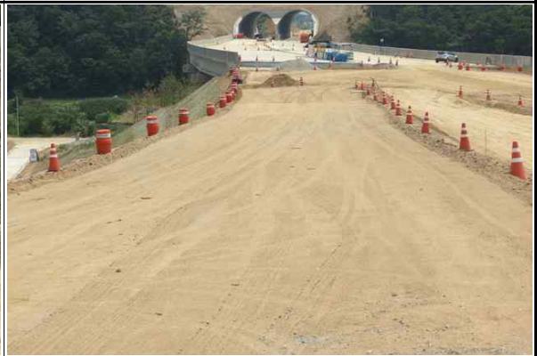
현장내 안전시설 설치 현황③
