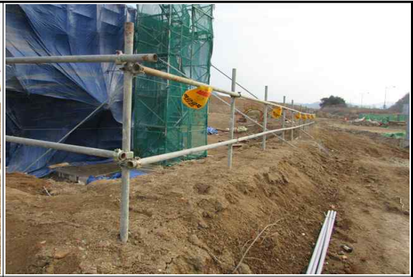
현장내 안전난간 설치 현황②
