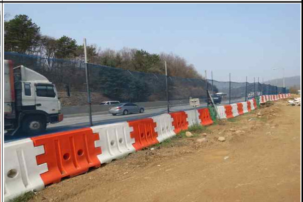
현장 인접도로 주변 안전시설(PE방호벽) 설치 현황②
