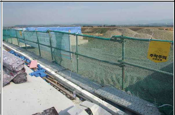
작업장내 안전난간 설치 현황
