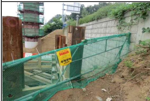
교각 P2 주변 안전시설 설치 현황
