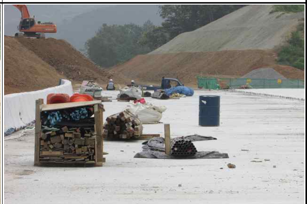
상부 교면 자재정리 미흡① (조치전)
